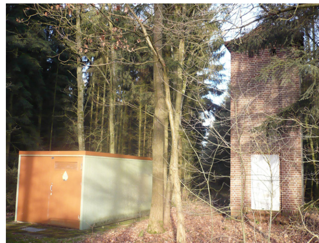
Abb. 36) Neu neben alt – der Trafoturm rechts ist ein historisches Kulturlandschaftselement
